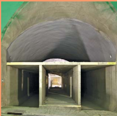
7) Definitivní ostění propojky nad mezistropem ze stříkaného betonu v křížení třípruhového tunelu s propojkou u TGC4
