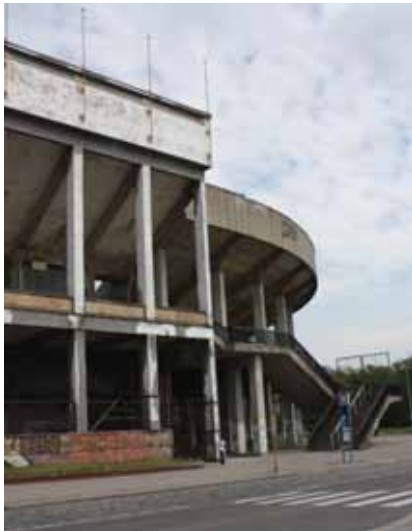
Betonový ochoz nacházející se na nároží mezi jižní a východní tribunou ilustruje omšelost vnější strany stadionu
